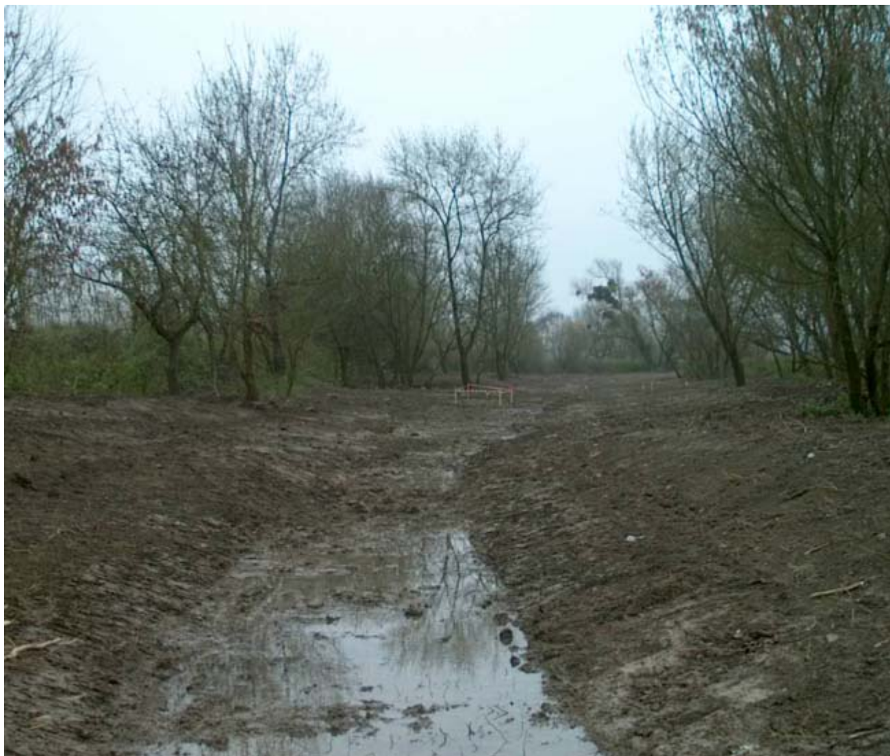
Exemple de terrassement avec remise en place de la terre végétale (Restauration d'une frayère à Brochet sur la commune de La Riche)
